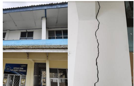
Gambar 12. Kondisi Gedung Eksisting Gedung SMP N 1 Cianjur
